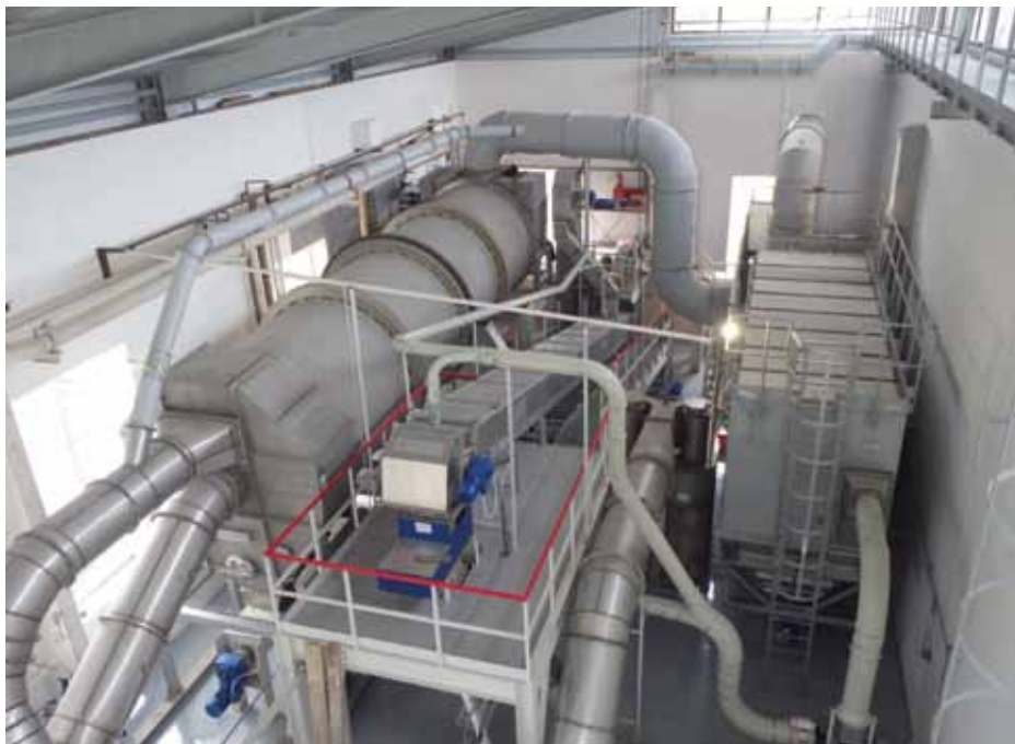
Рис. 4. Вид установки построенной согласно представленному принципу на Хмелинецком сахарном заводе
